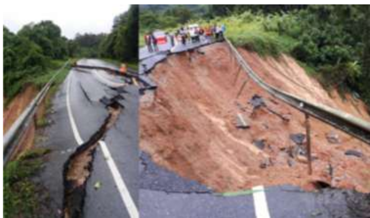
รูปที่ 2.6 ทางขาด-ดินทรุดบริเวณถนนสาย 401ช่วงเขาสก รอยต่อพังงา-สุราษฎร์ธานี
