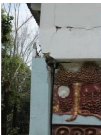
รูปที่2.24 เสาวิบัติแบบเฉือน เนื่องจากแรงมหาศาลส่งถ่ายจากผนังอิฐก่อ
