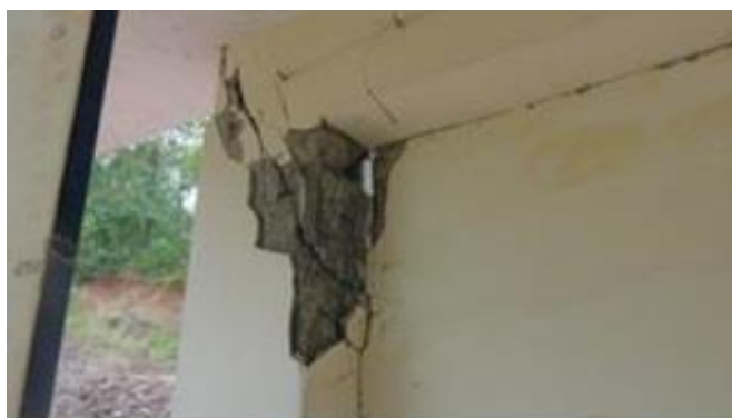
รูปที่ 2.19 โรงเรียนบ้านคอนตัน อำเภอพาน จังหวัดเชียงราย เสาประชิดผนังอิฐก่อแตกร้าวแบบเฉือน
