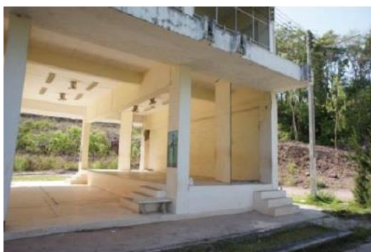
รูปที่ 2.18 โรงเรียนบ้านคอนตัน อำเภอพาน จังหวัดเชียงราย ผนังอิฐก่อในช่วงเสาปลายสุดด้านขวา
