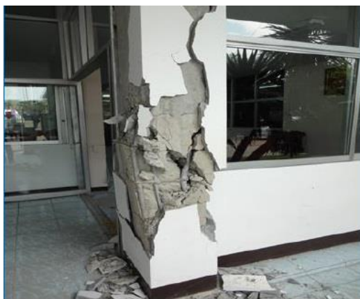
รูปที่2.25 เสาวิบัติแบบเฉือนลักษณะเป็นเสาสั้น- โรงเรียนพานพิทยาคม
