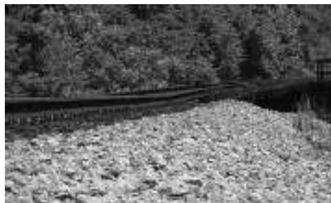
รูปที่ 2-8 ภาพแสดงการทรุดตัวของรางบริเวณ Bridge Approach(ที่มา: Dingqing Li, James Hyslip, Ted Sussmann, Steven Chrismer 2015)
