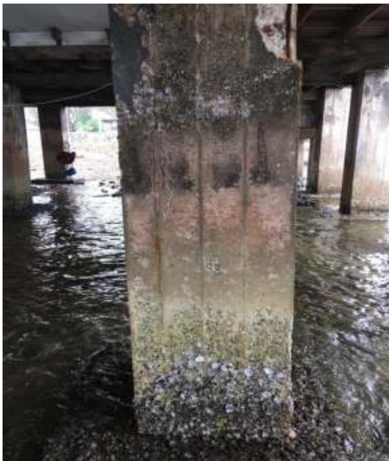
รูป 4.2 ความเสียหายของเสา(การหลุดร่อน)
