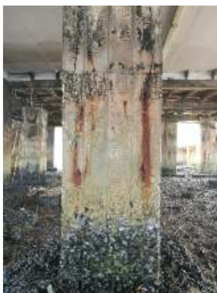
รูปที่ 3.3 การแตกร้าวของเสาคอนกรีตที่เรือนรัฐธรรมนูญ
