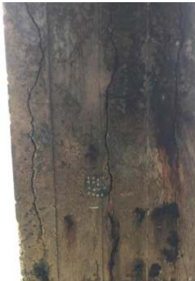
รูป 4.1 ความเสียหายของเสา(รอยร้าว)
