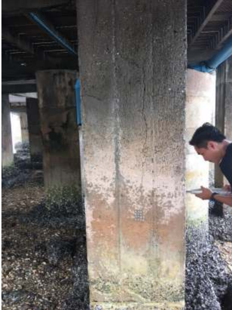
ภาพที่ 1 การทดสอบกำลังรับแรงอัดของเสาด้วย rebound hammer
