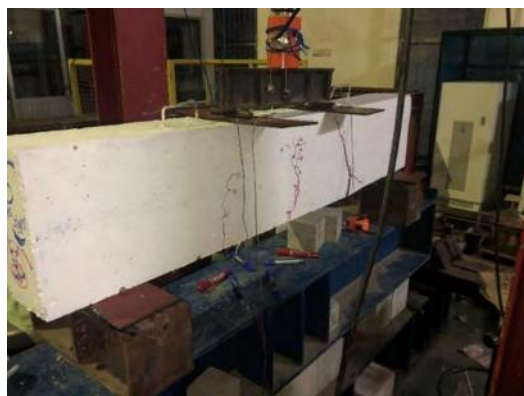
รูปที่ 4.6 การวิบัติของคาน B5
