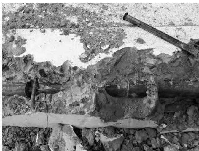
รูปที่ 4.10 การรูดของไม้ไผ่กับคอนกรีตเนื่องจากกำลังยึดเหนี่ยวไม้เพียงพอ
